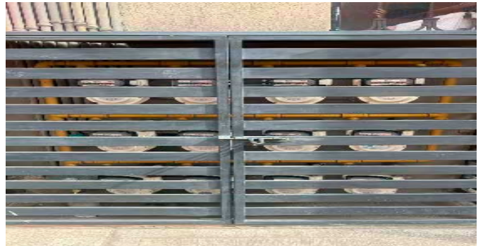
Contador de Gas
