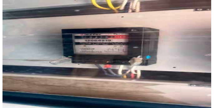
Contador de Energia
