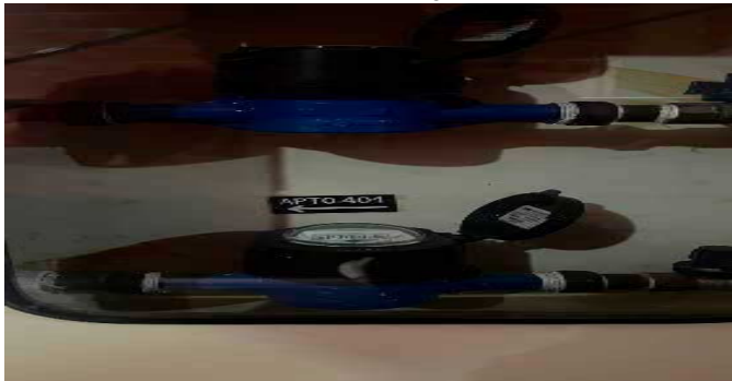
Contador de Agua
