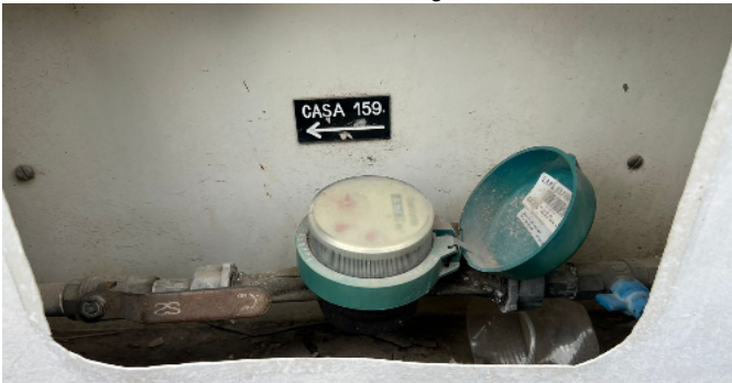
Contador de Agua
