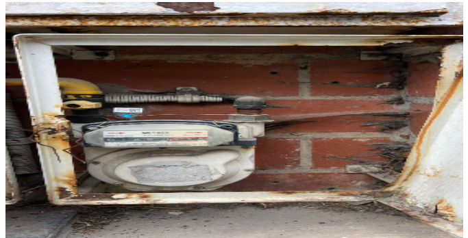
Contador de Gas
