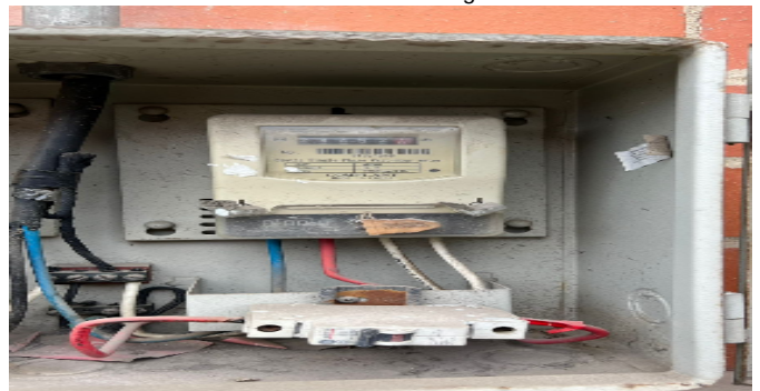
Contador de Energia
