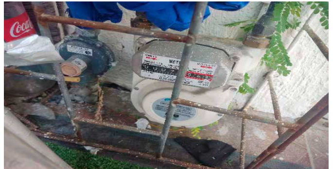
Contador de Gas
