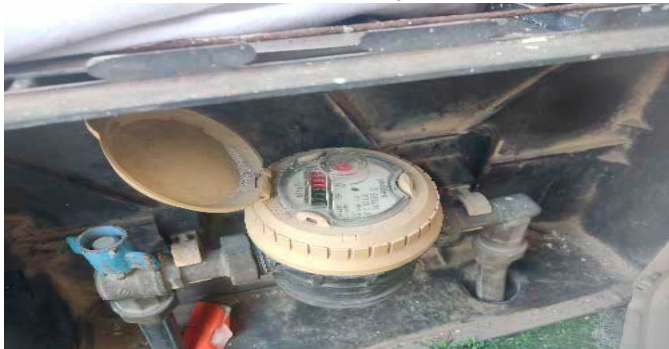
Contador de Agua
