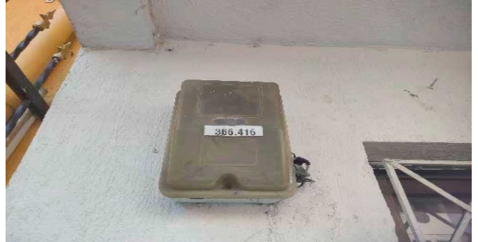
Contador de Energia
