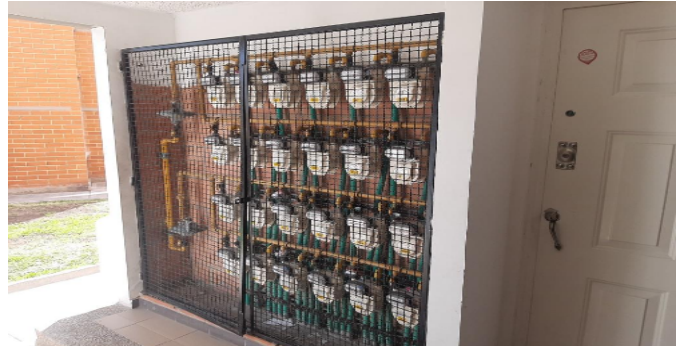
Contador de Gas
