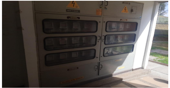
Contador de Energia
