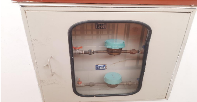
Contador de Agua
