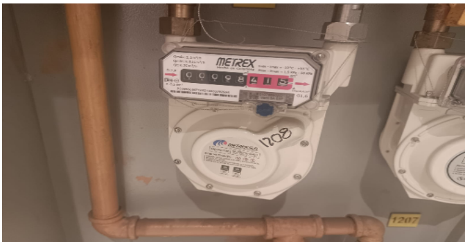
Contador de Gas
