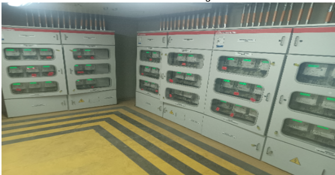
Contador de Energia
