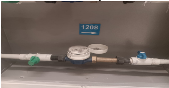
Contador de Agua
