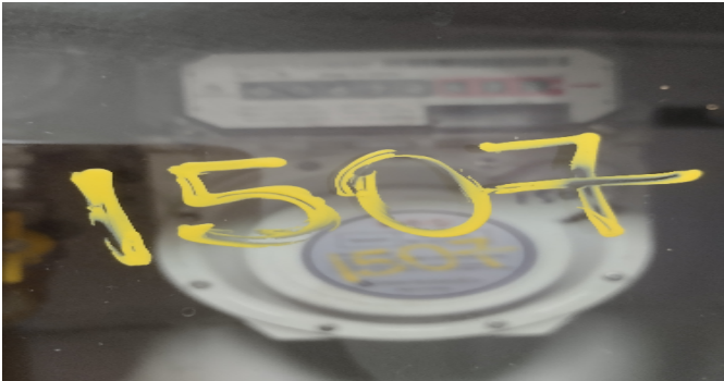
Contador de Gas
