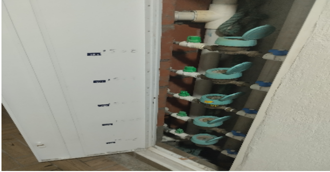
Contador de Agua
