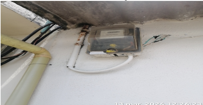
Contador de Energia
