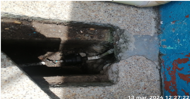
Contador de Agua
