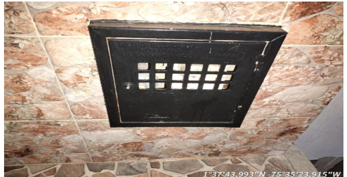
Contador de Gas
