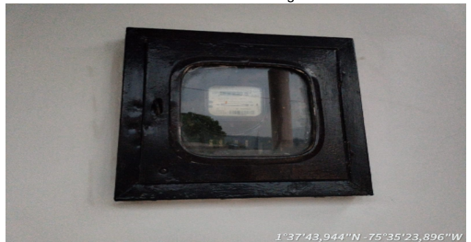
Contador de Energia
