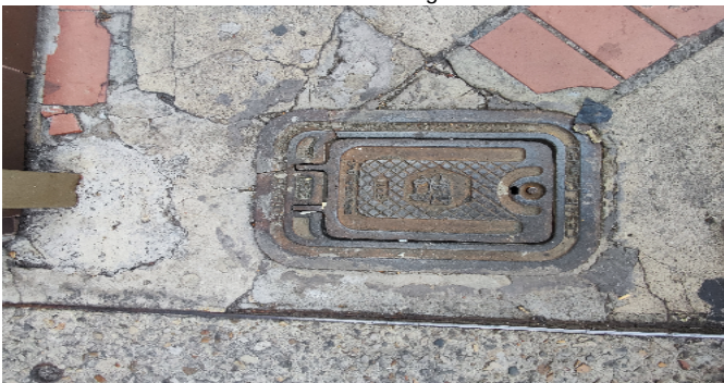
Contador de Agua
