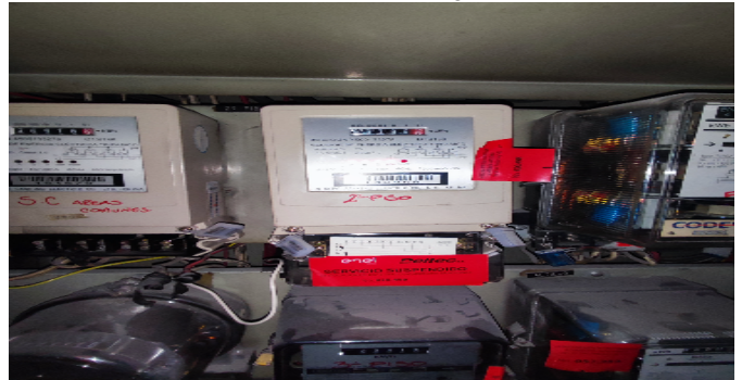
Contador de Energia
