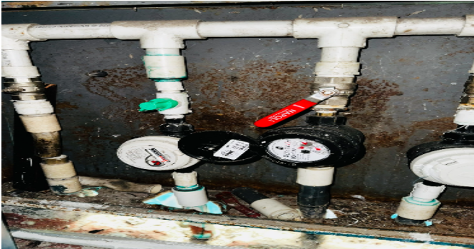
Contador de Agua
