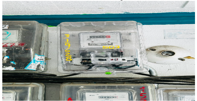
Contador de Energia
