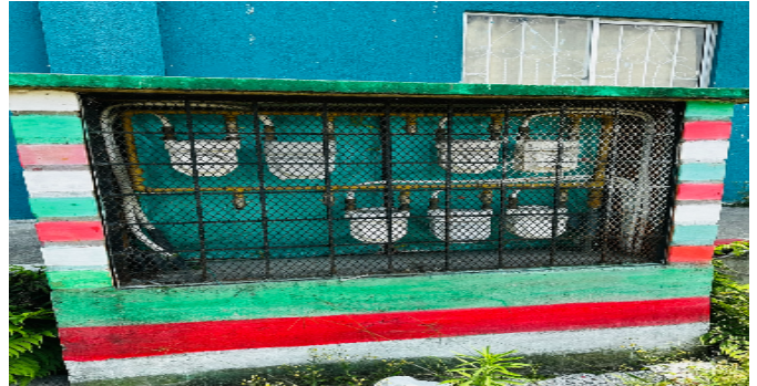
Contador de Gas
