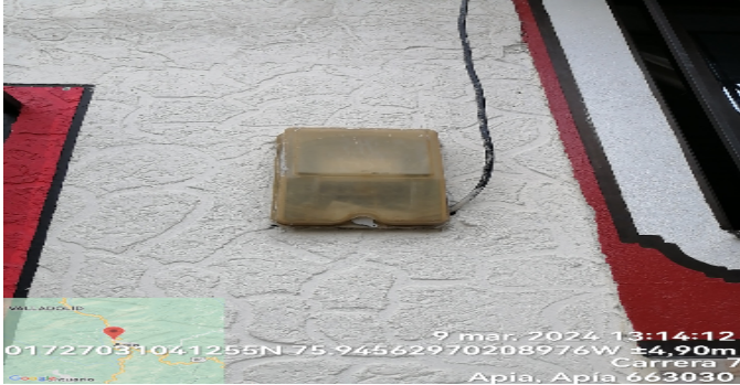
Contador de Energia
