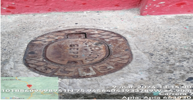
Contador de Agua
