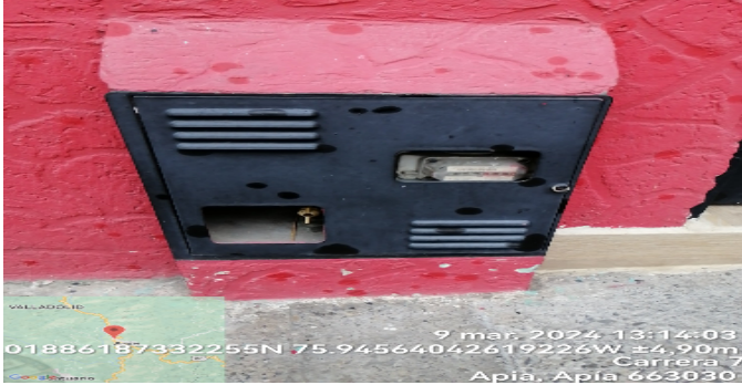
Contador de Gas
