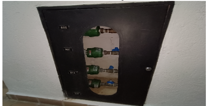
Contador de Agua
