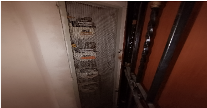
Contador de Gas
