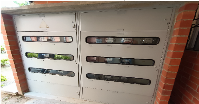
Contador de Energia
