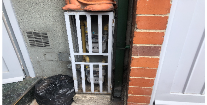
Contador de Gas
