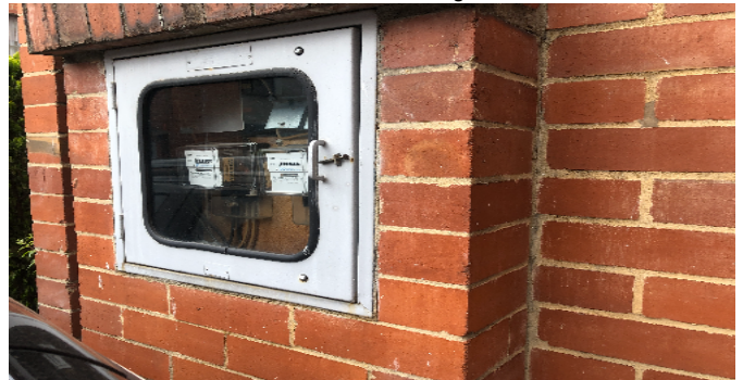
Contador de Energia
