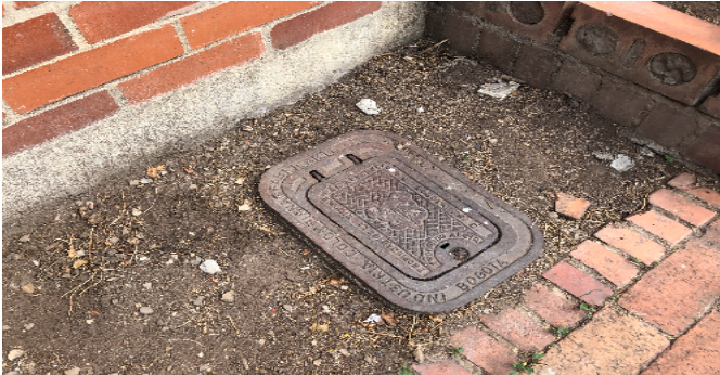
Contador de Agua
