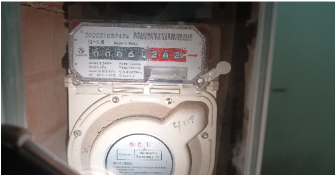
Contador de Gas
