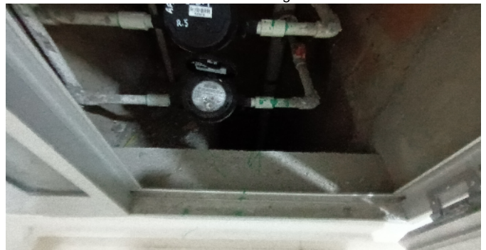
Contador de Agua
