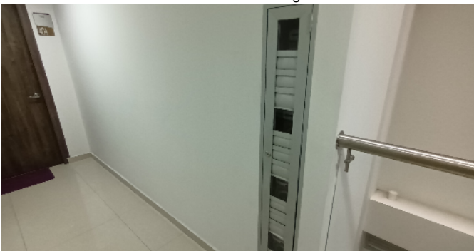
Contador de Energia
