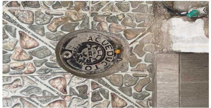
Contador de Agua
