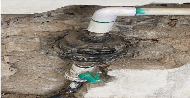
Contador de Gas
