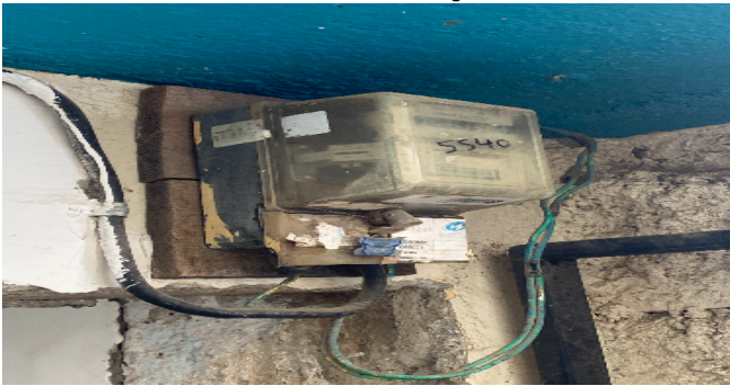
Contador de Energia
