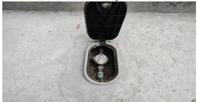
Contador de Agua
