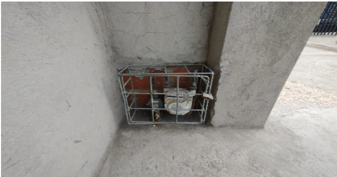
Contador de Gas
