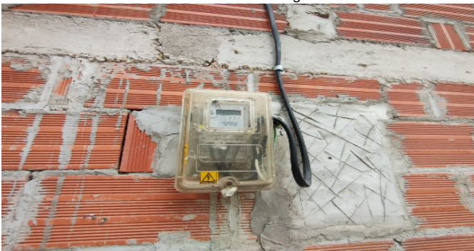
Contador de Energia
