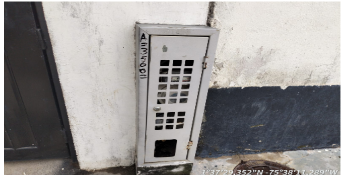
Contador de Gas
