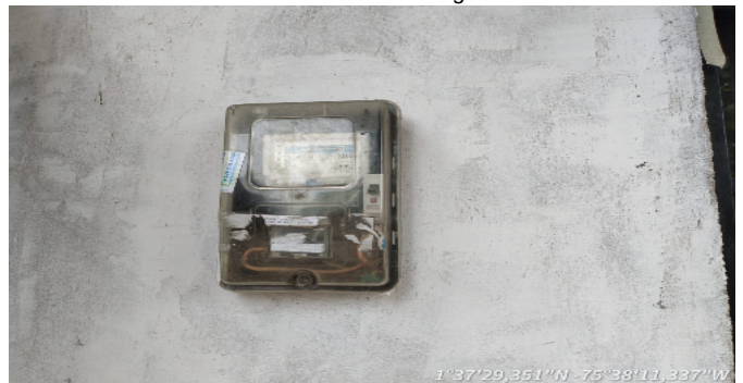
Contador de Energia
