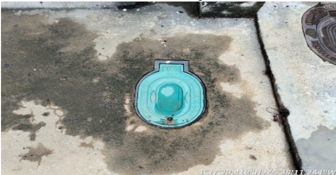
Contador de Agua
