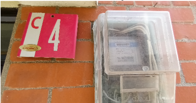
Contador de Energia
