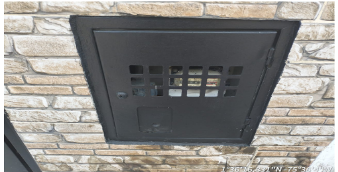
Contador de Gas
