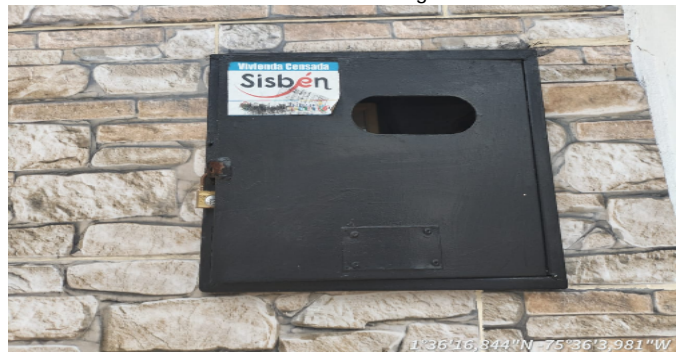
Contador de Energia
