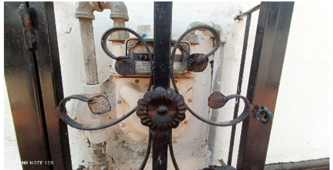
Contador de Gas
