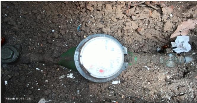
Contador de Agua
