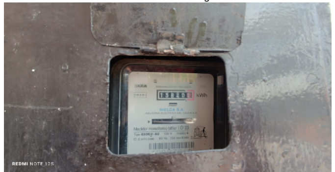
Contador de Energia
