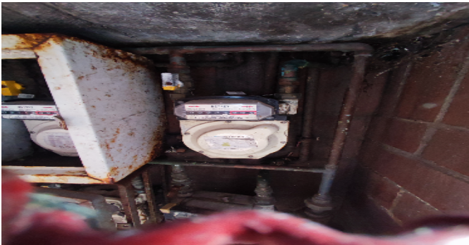
Contador de Gas
