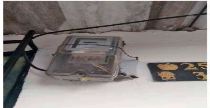
Contador de Energia
