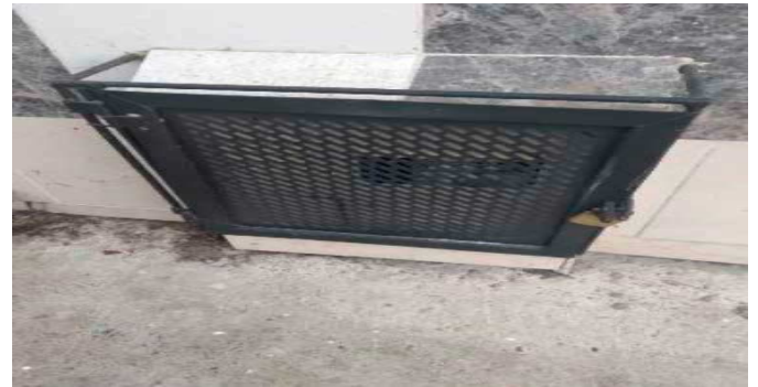
Contador de Gas
