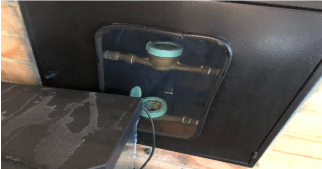
Contador de Agua
