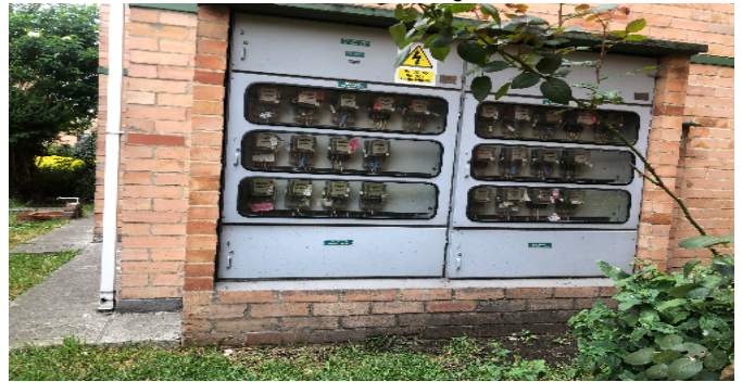
Contador de Energia
