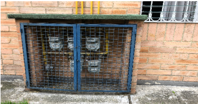
Contador de Gas
