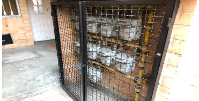
Contador de Gas
