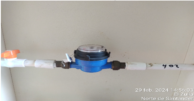
Contador de Agua
