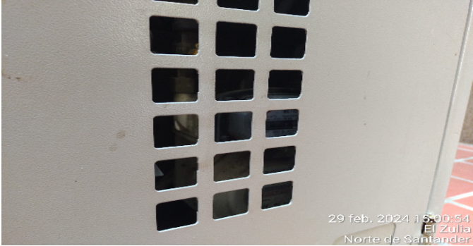
Contador de Gas
