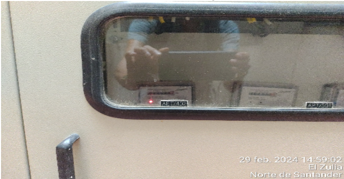
Contador de Energia
