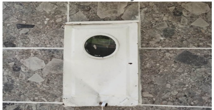
Contador de Energia
