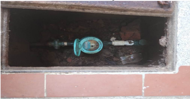
Contador de Agua
