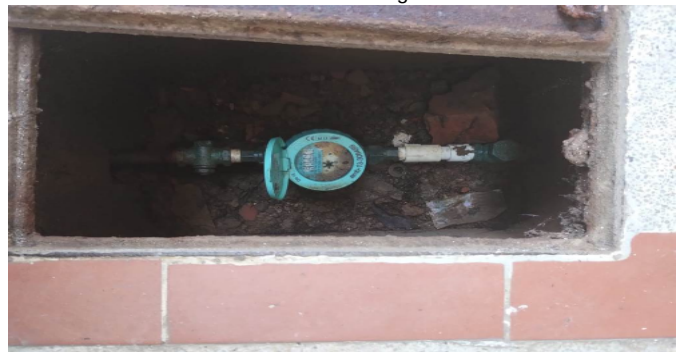
Contador de Agua
