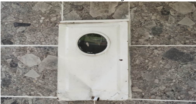
Contador de Energia
