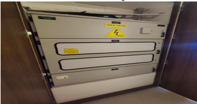
Contador de Energia
