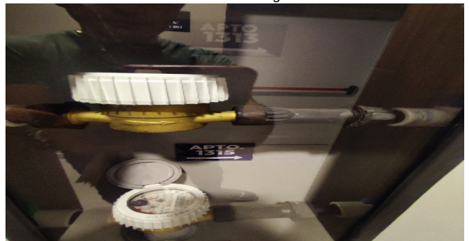
Contador de Agua
