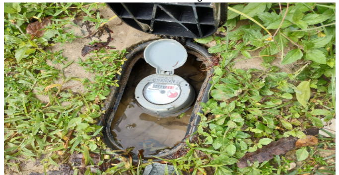
Contador de Agua
