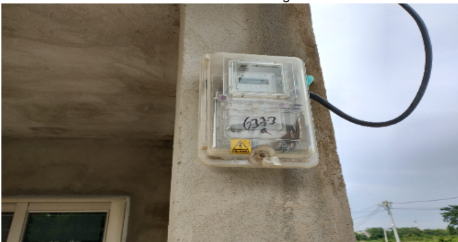
Contador de Energia
