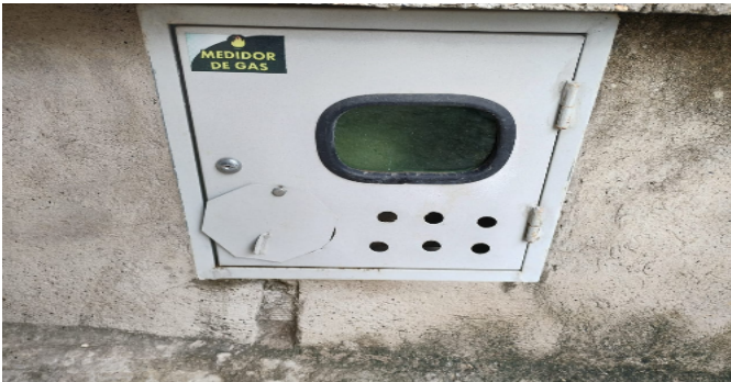
Contador de Gas
