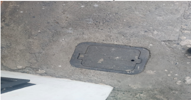
Contador de Agua
