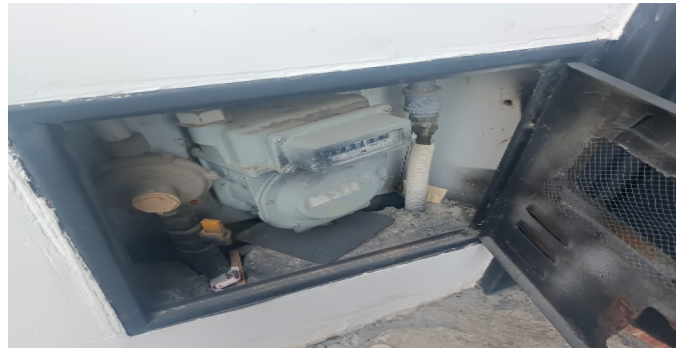
Contador de Gas
