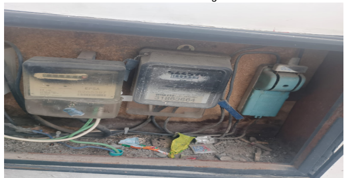
Contador de Energia
