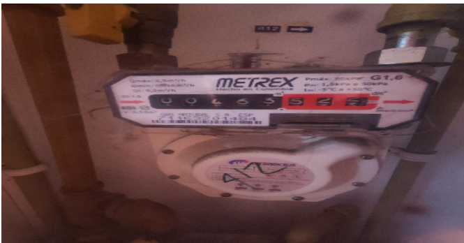
Contador de Gas
