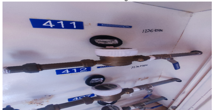
Contador de Agua
