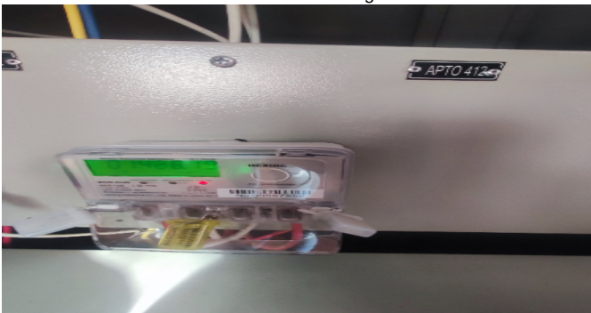
Contador de Energia
