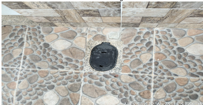
Contador de Agua
