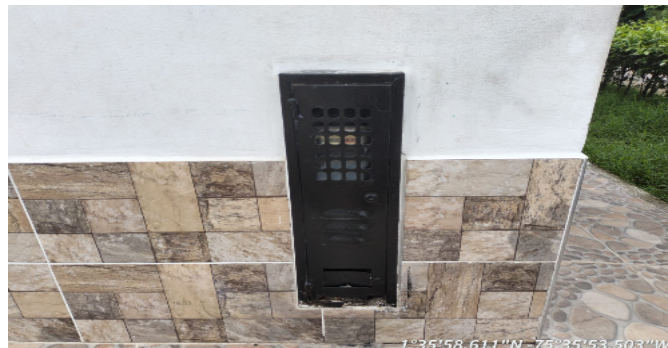
Contador de Gas
