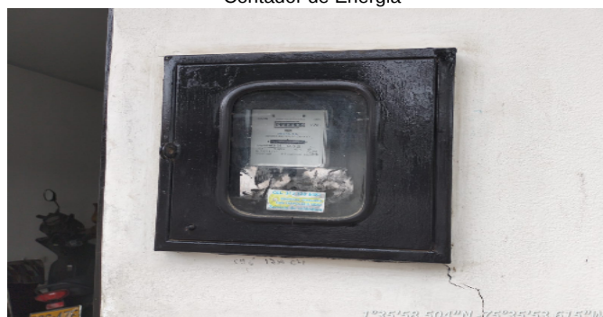
Contador de Energia
