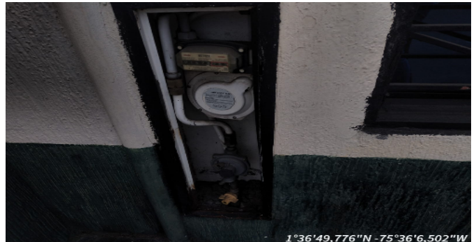
Contador de Gas
