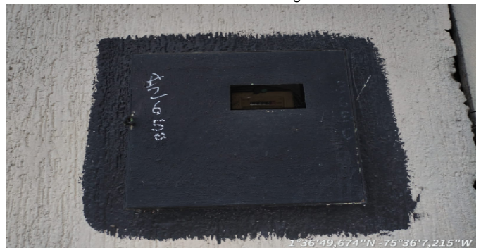
Contador de Energia
