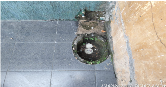
Contador de Agua
