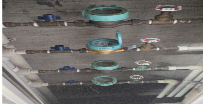
Contador de Agua
