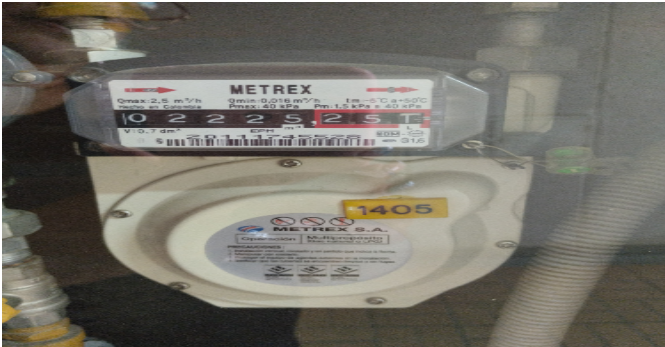
Contador de Gas
