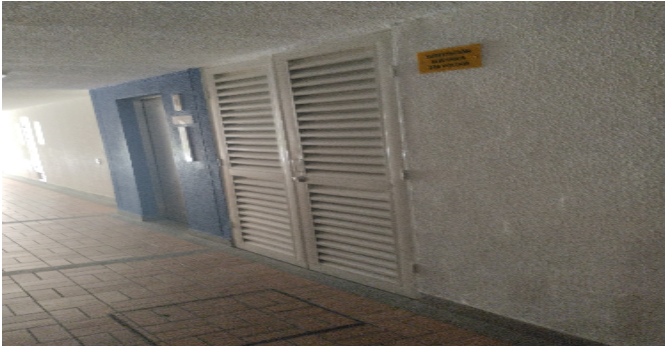
Contador de Energia
