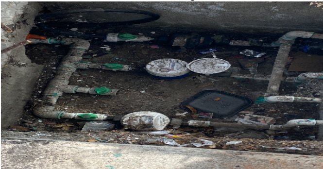
Contador de Agua
