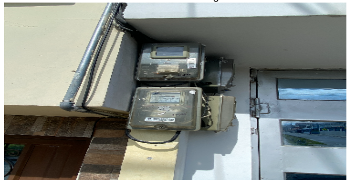
Contador de Energia
