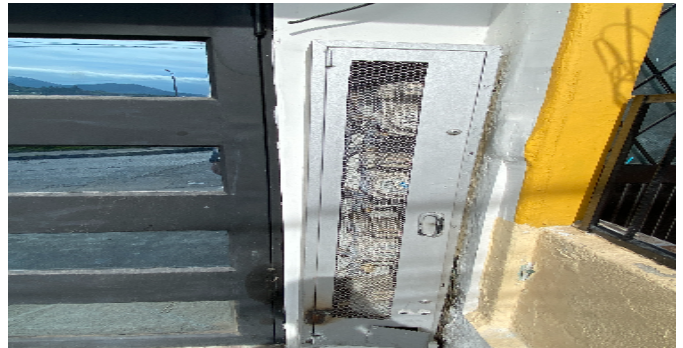
Contador de Gas
