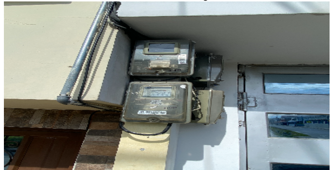
Contador de Energia
