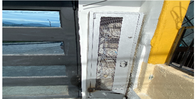
Contador de Gas
