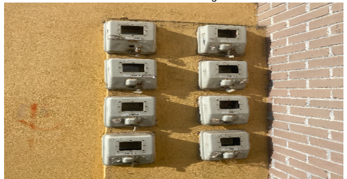
Contador de Energia
