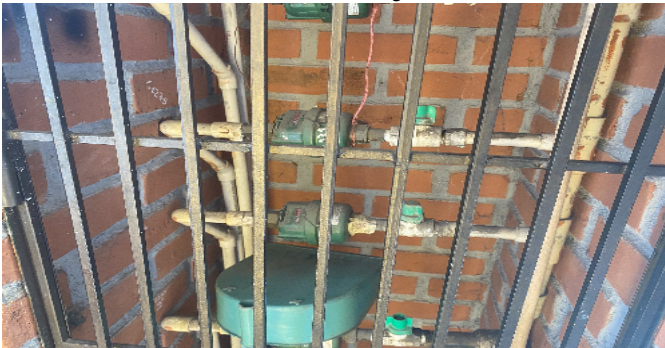
Contador de Agua
