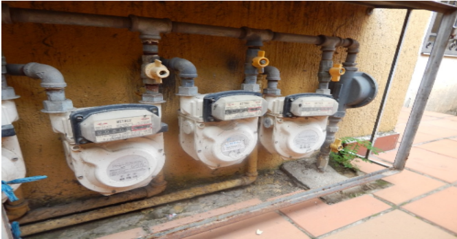
Contador de Gas
