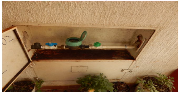
Contador de Agua
