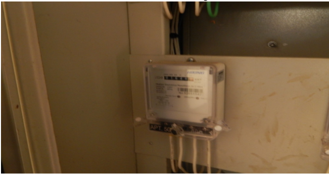
Contador de Energia
