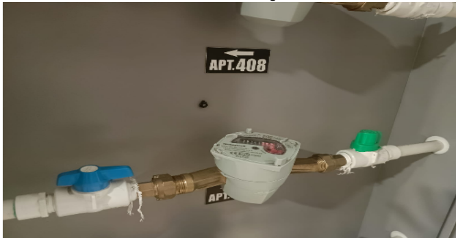
Contador de Agua
