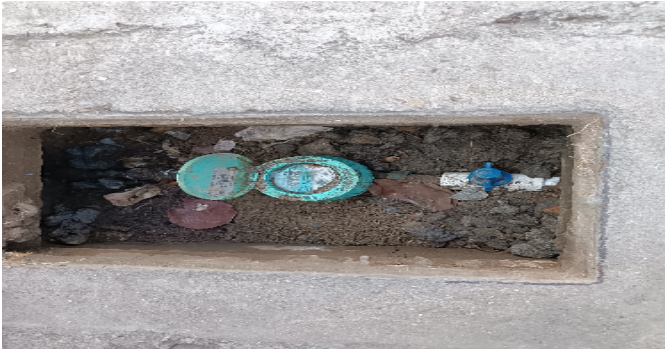
Contador de Agua
