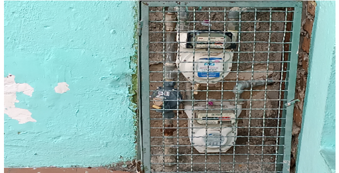
Contador de Gas
