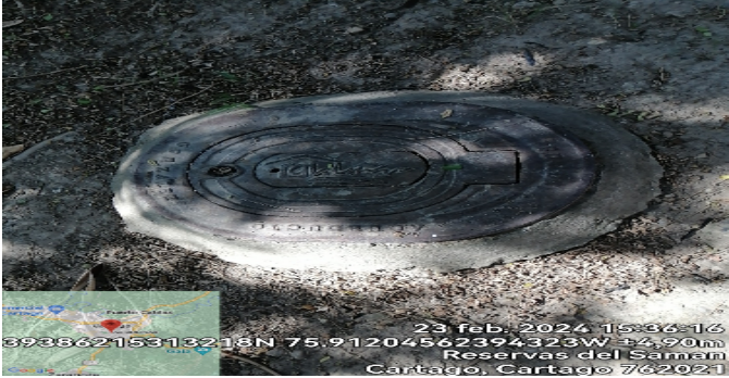
Contador de Agua
