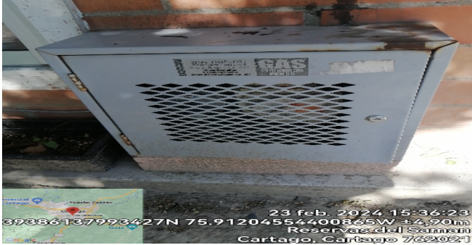
Contador de Gas
