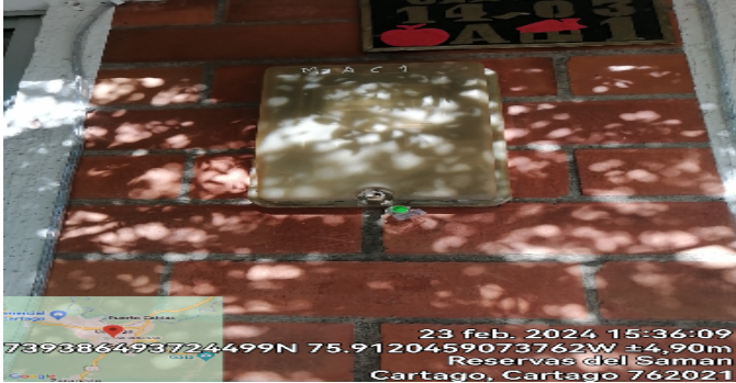
Contador de Energia
