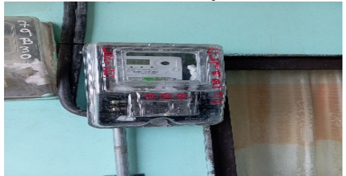
Contador de Energia
