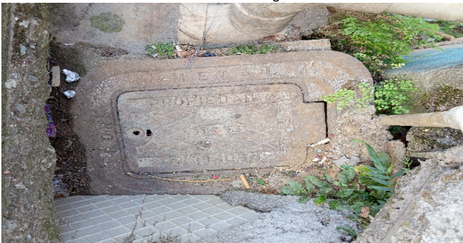
Contador de Agua
