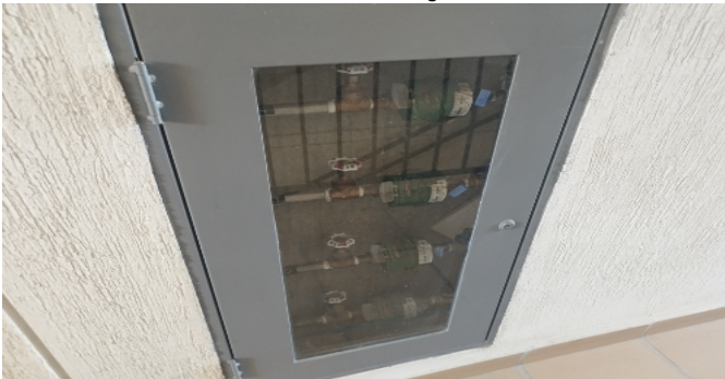
Contador de Agua
