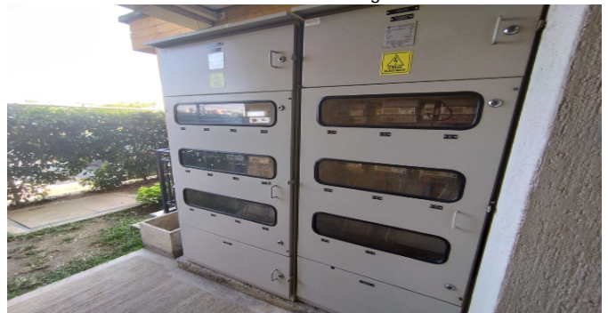
Contador de Energia
