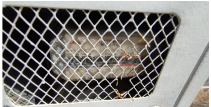
Contador de Gas
