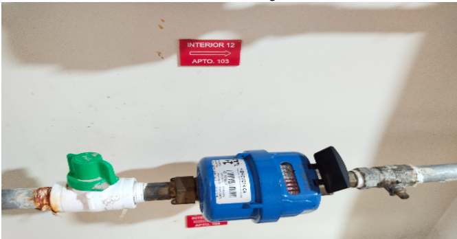
Contador de Agua
