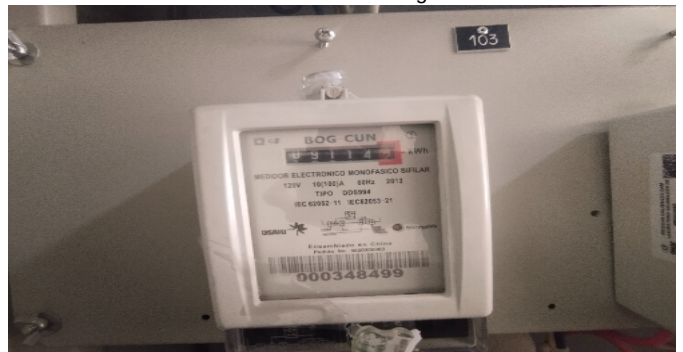
Contador de Energia
