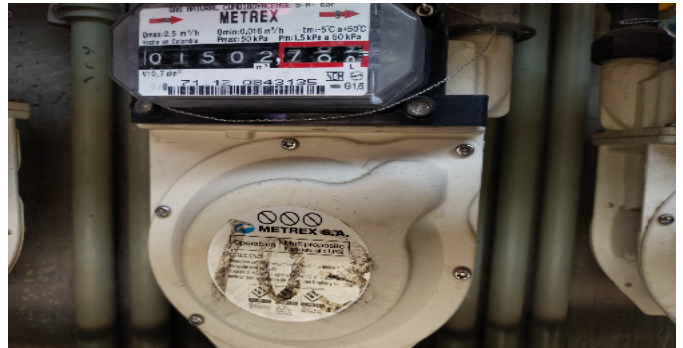
Contador de Gas
