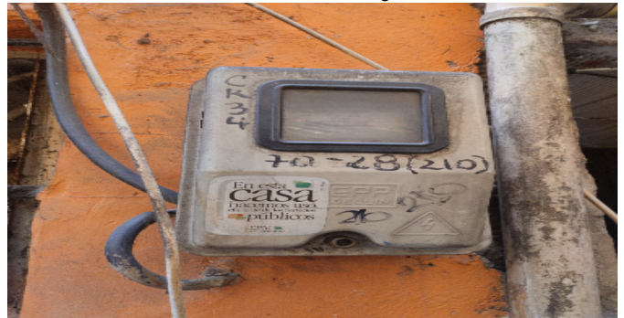
Contador de Energia
