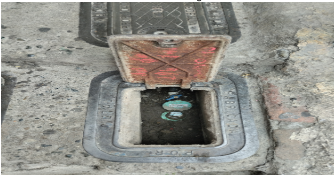
Contador de Agua
