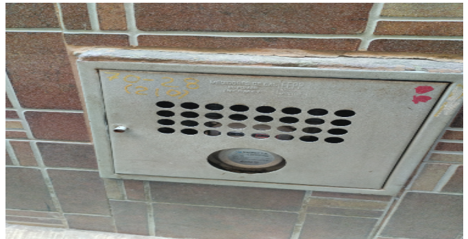
Contador de Gas
