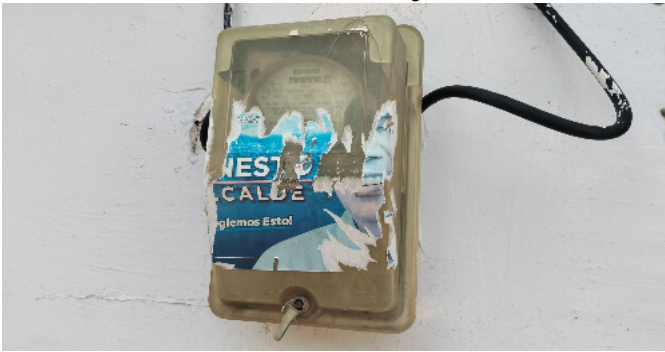
Contador de Energia
