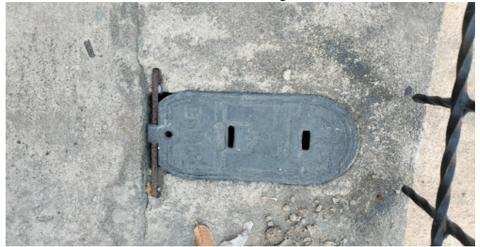
Contador de Agua
