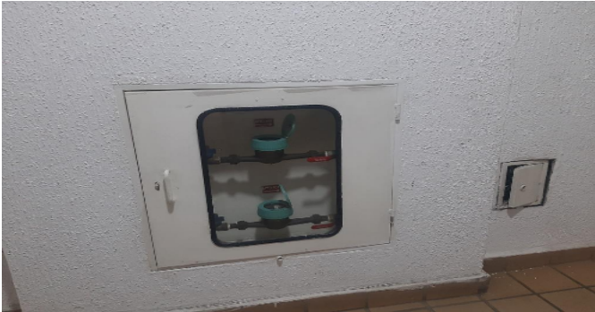
Contador de Agua
