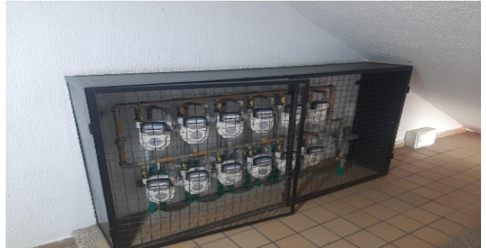
Contador de Gas
