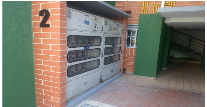
Contador de Energia
