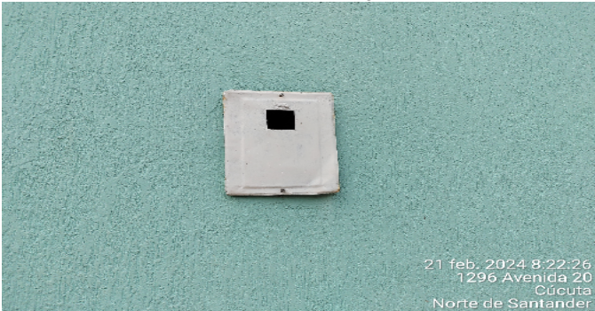
Contador de Energia
