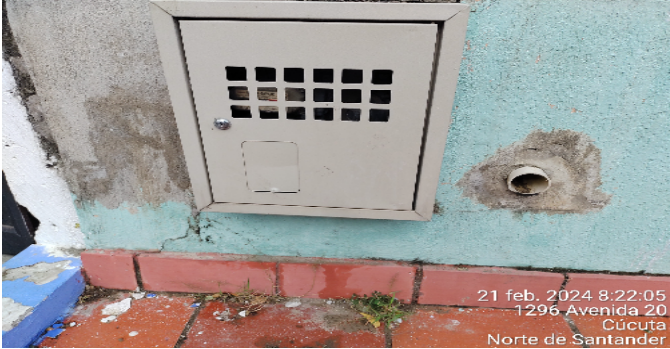
Contador de Gas
