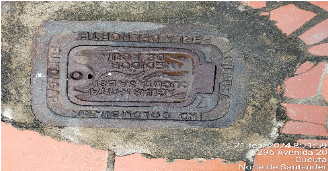
Contador de Agua
