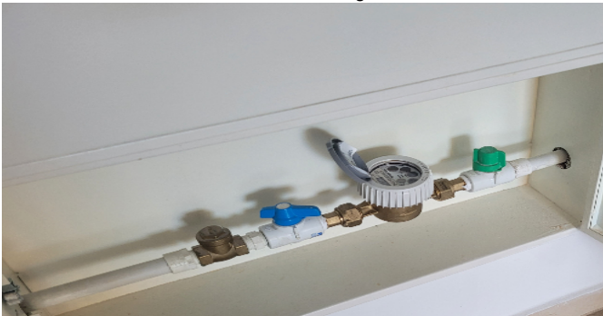
Contador de Agua
