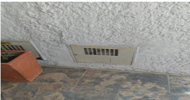
Contador de Gas
