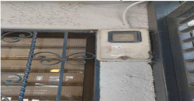
Contador de Energia
