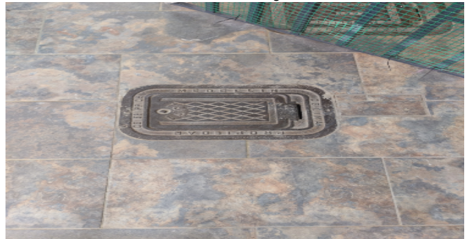
Contador de Agua
